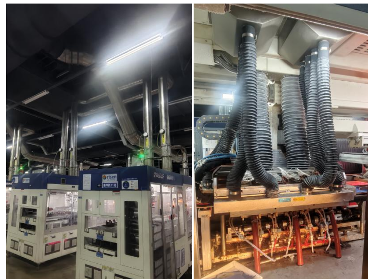
串焊废气收集与排放设备
